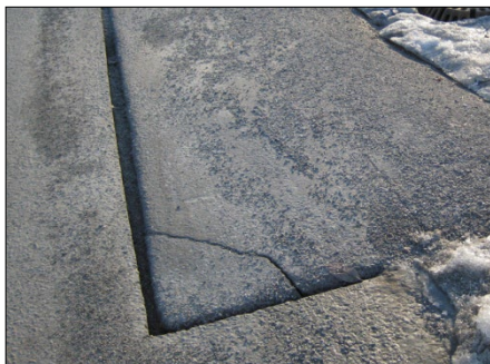
Uriktig utført asfaltskjøt uten fortanning
