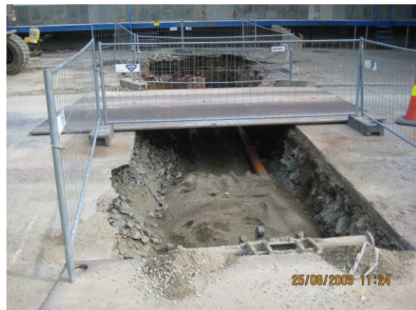
Kjøreplate er ikke frest ned i dekket
